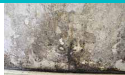
▲ Présence d'humidité intérieure.
